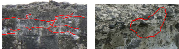
a) 網目状ひび割れ
