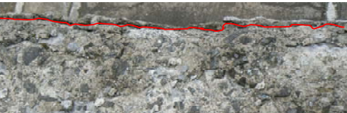
c) 表層スケーリング(表層部の浮き)
