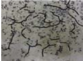
図1 収縮ひび割れの例
